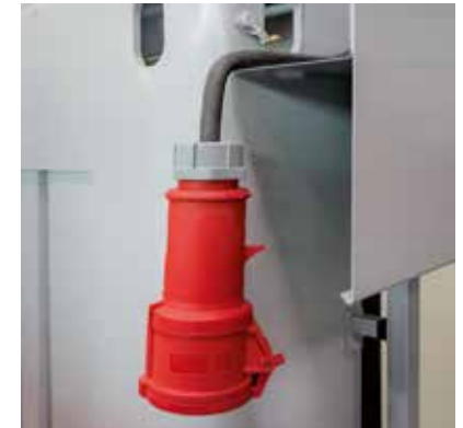
Elektroverbindung hinter der Attikablende
