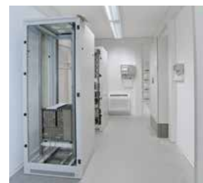
Technikraum und Servertechnik
